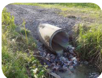
Exempel på hantering av dagvatten med öppna diken och trumma under grusad väg/överfart.
